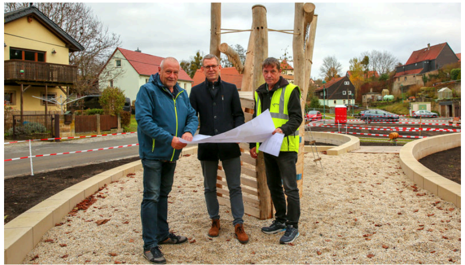
Von links: Uwe Gebauer (Heimatverein Liebethal), Bürgermeister Markus Dreßler und Frank Weber (verantwortlicher Projektbearbeiter der Fachgruppe Tiefbau) begutachten den Liebethaler Dorfplatz vor dem Bauabschluss (Foto: Stadtverwaltung)
