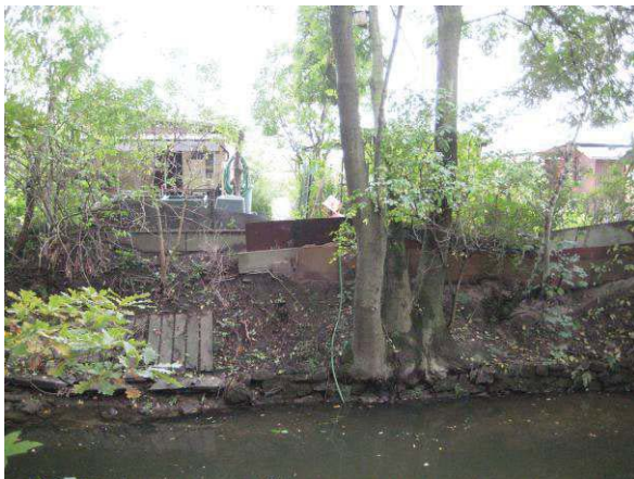
Abb. 9: Maroder Uferverbau in der Anlage P 109.2 „Gartenfreude“
